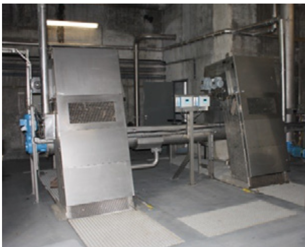
Dégrilleurs automatiques de la STEP de Viesville
