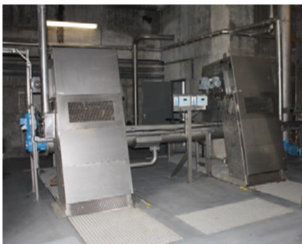
Dégrilleurs automatiques de la STEP de Viesville
