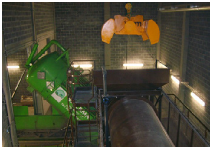
Camion déversant des PCRA et grappin de la fosse de réception des PCRA de la STEP de Marchienne-au-Pont
