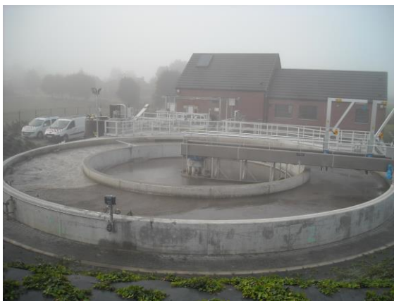
Station d'épuration de Fleurjoux
